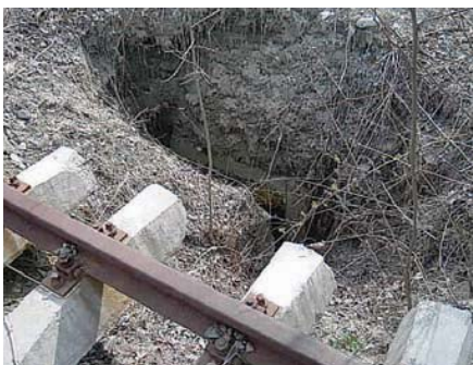
Foto 1: Alunecare de teren pe amplasamentul liniei de cale ferată
