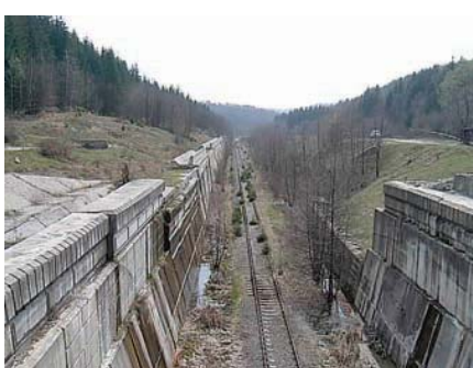
Foto 2: Suprastructură CF degradată
