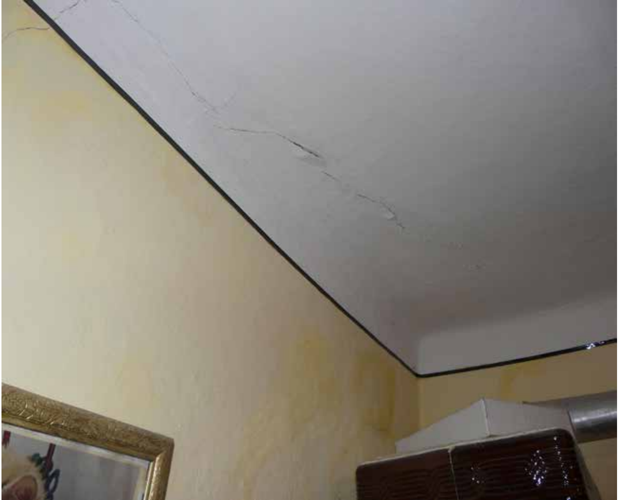
Crăpături în tavanul unei locuințe reflectând un posibil fenomen de tasare
