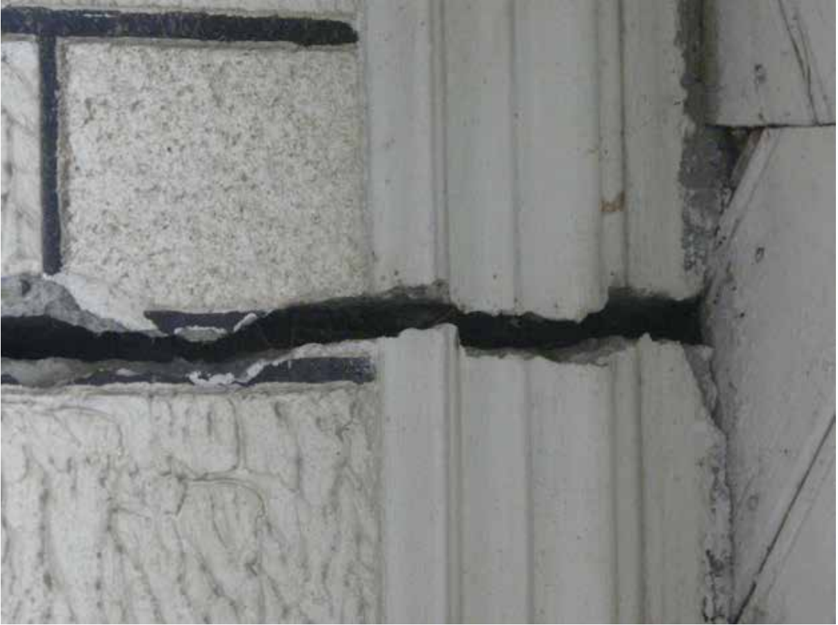
Crăpături rezultate în urma unui posibil proces de tasare
