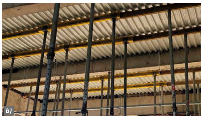
Fig. 2: a) Șabloane pentru aducerea în cotă a tablei cutate; b) Rezemarea tablei cutate la montaj
