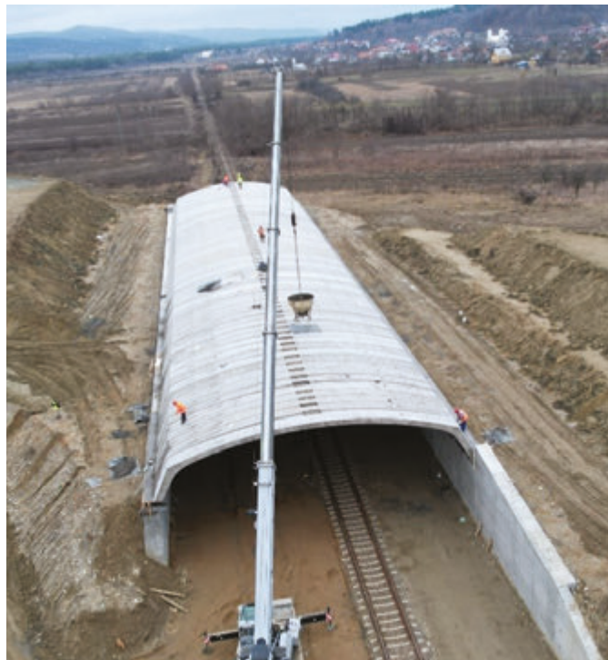
Fig. 4: Montajul finalizat al celor 70 de arce prefabricate din beton armat armate ale Pasajului CF de pe A1, km 104-484
